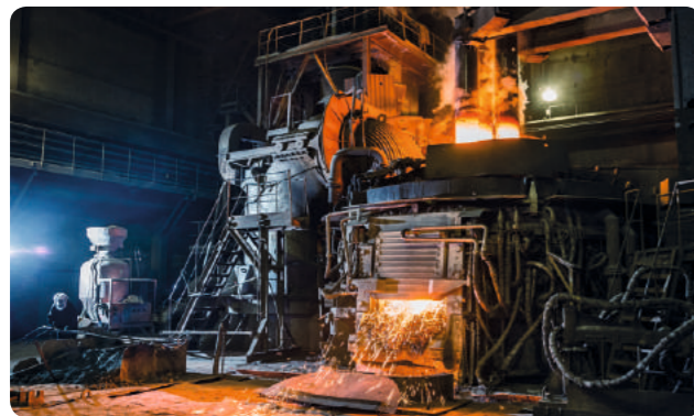
Дуговая электросталеплавильная печь ДСП 60/70 (FAI-FUCHS)
